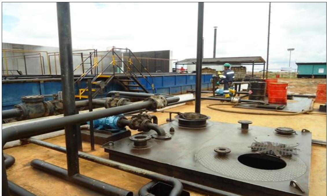
Figura 6. Área de recuperación de crudo, tanque sumidero y punto de inyección de químicos, Campo Cabiona
