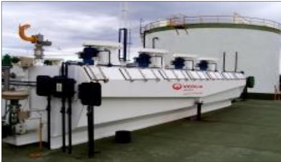
Figura 23. Separador de flotación por gas inducido (IGF)
