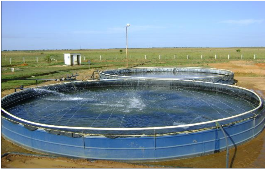
Figura 9. Tanques australianos para enfriamiento del agua de producción Campo Cabiona
