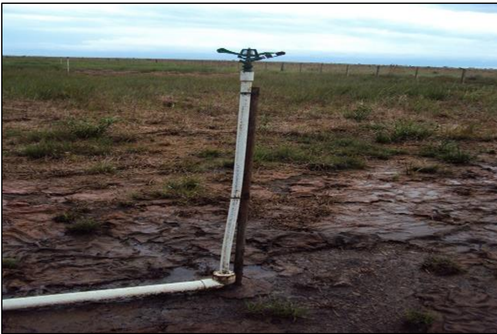
Figura 14. Contaminación por sólidos, zona de aspersión, Campo Cabiona
