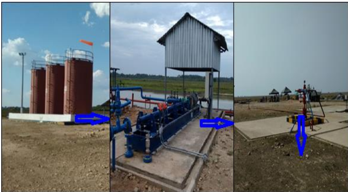
Figura 47. Facilidades y equipos de reinyección en un pozo disposal
