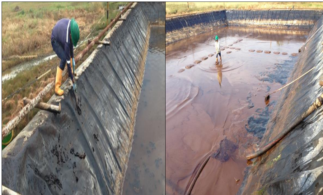
Figura 50. Contaminación de piscinas de enfriamiento con lodos y aceite, Campo Cabiona
