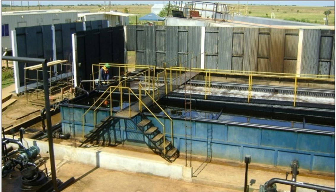
Figura 5. Equipos básicos primarios para el tratamiento de aguas, Campo Cabiona
