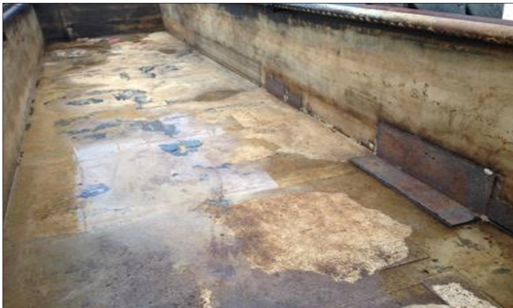
Figura 49. Continuas reparaciones a catch tank, Campo Cabiona
