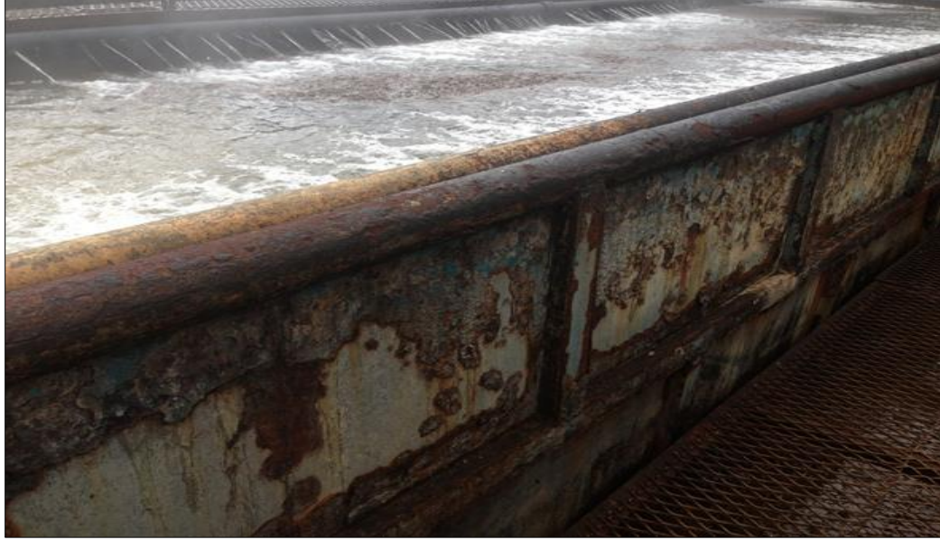
Figura 48. Deterioro de los catch tank de tratamiento ARI, Campo Cabiona
