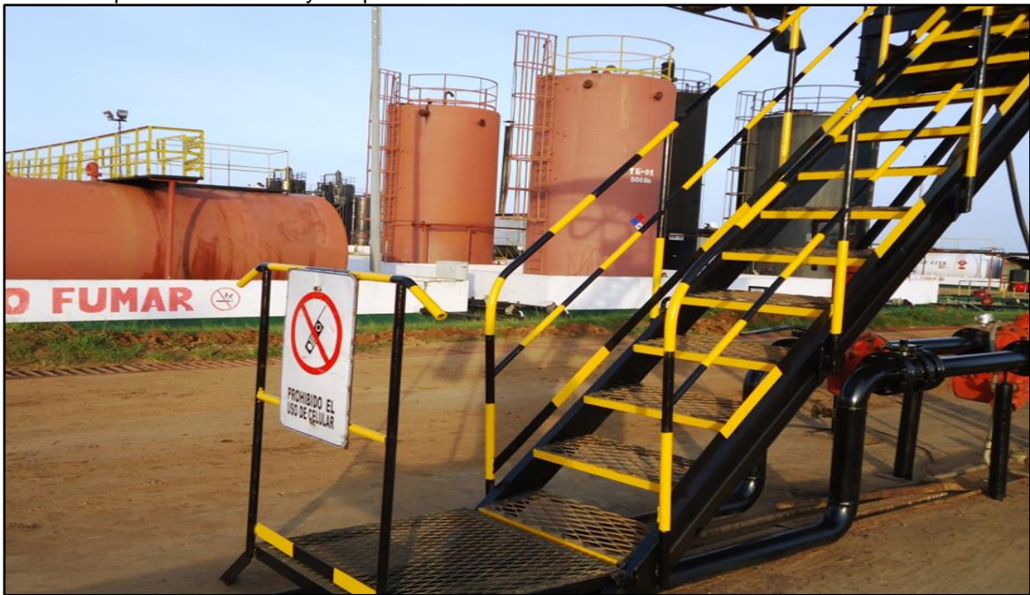
Figura 4. Facilidad con 4 tanques horizontales de almacenamiento de crudo, y 2 tanques verticales para fiscalización y despacho.
