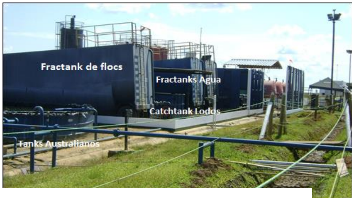
Figura 8. Fractanks habilitados para el tratamiento ARI, Campo Cabiona
