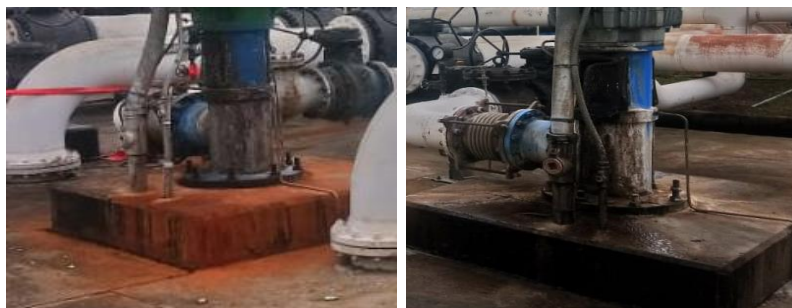
Figura 21 Contaminación por pérdida de contención
