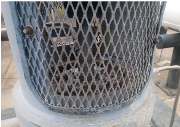
figura 27 bomba con sello mecánico
