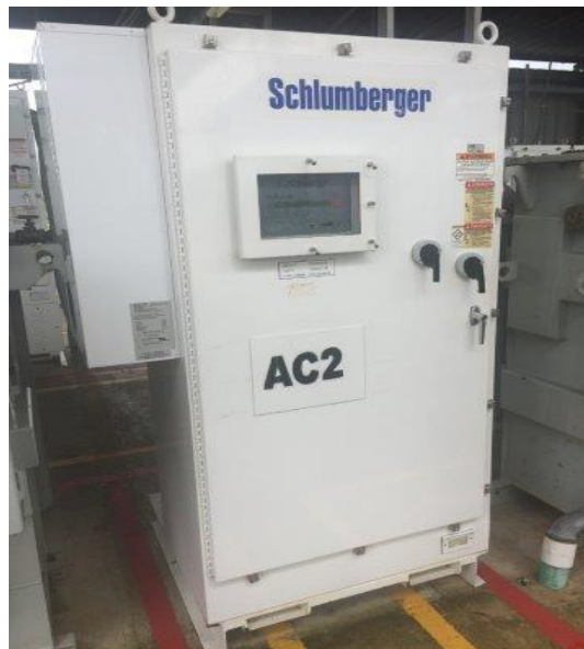
Figura 1. Variador de frecuencia
