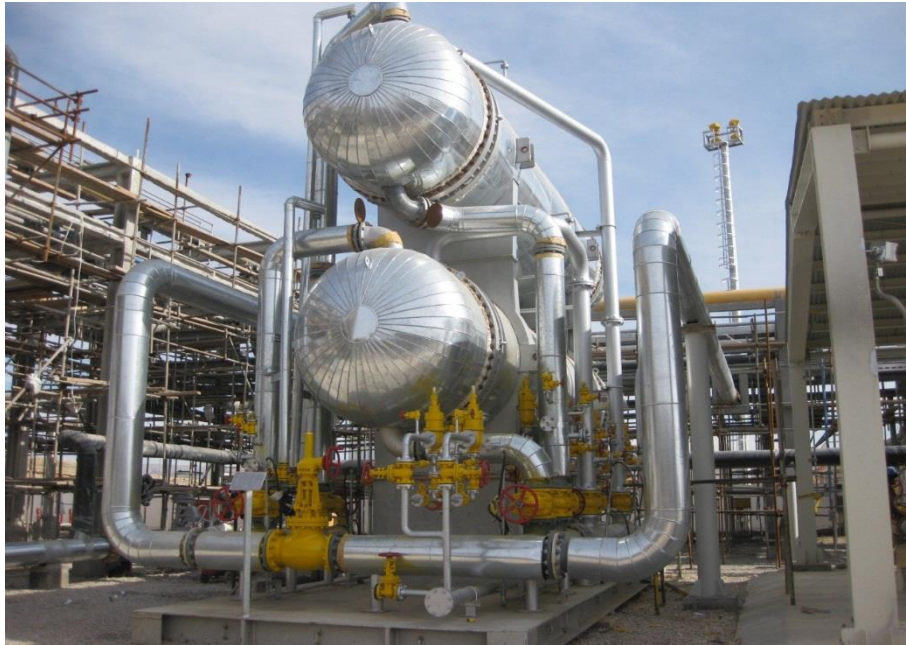
Imagen 10. intercambiador de calor.
