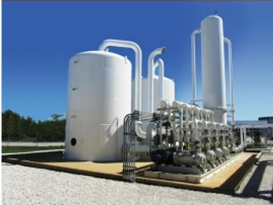
Imagen 15. Unidad de recuperación de vapor.
