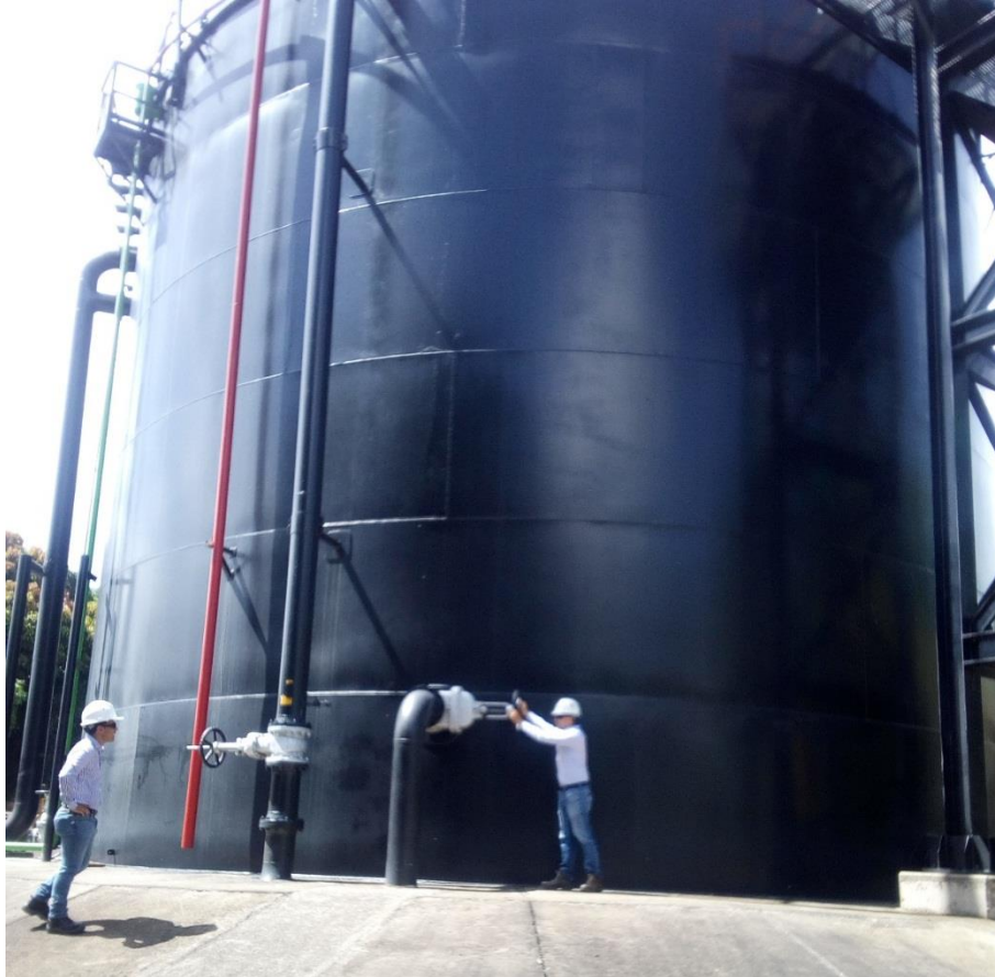
Imagen 12. Tanque de almacenamiento de crudo.
