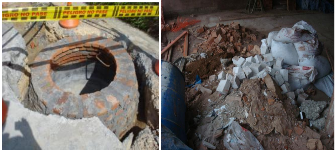
Foto 12. Desperdicio de ladrillo en obra
