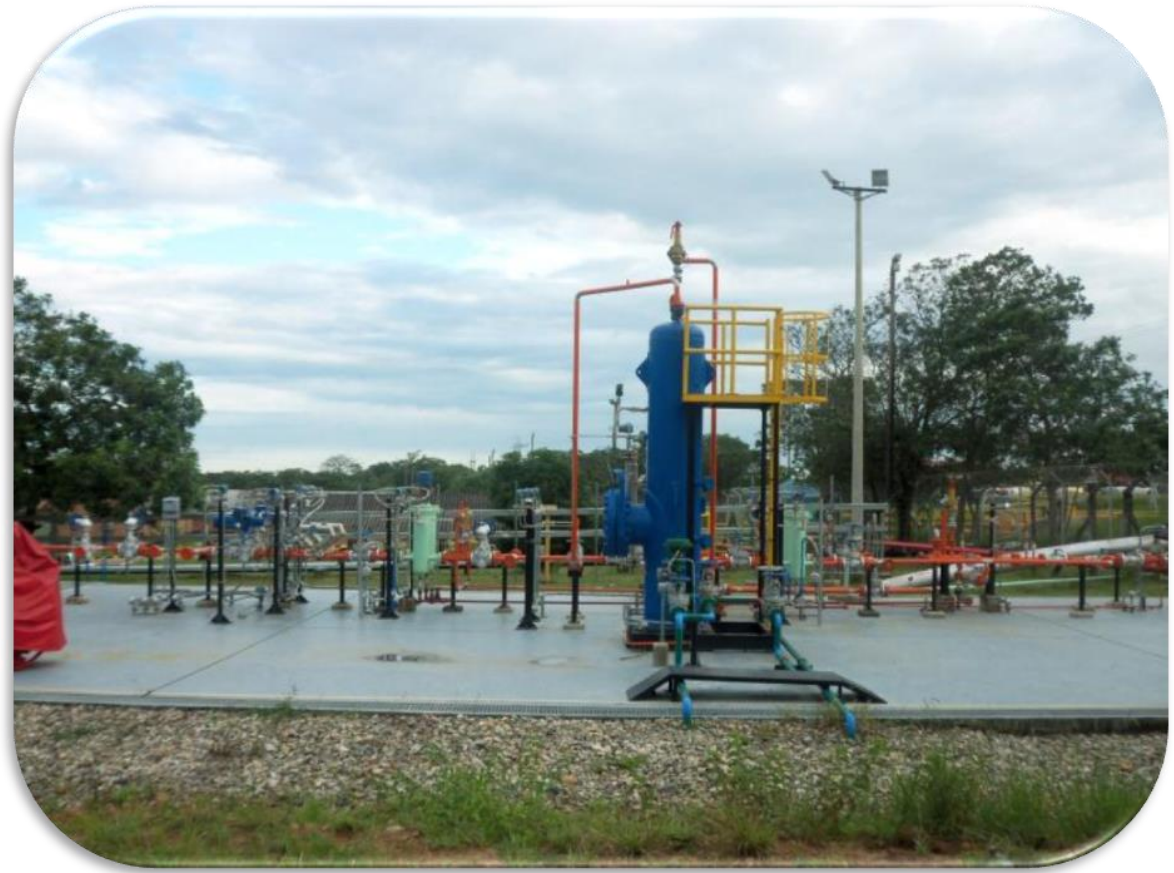
Figura 3. Foto Estación City Gate
