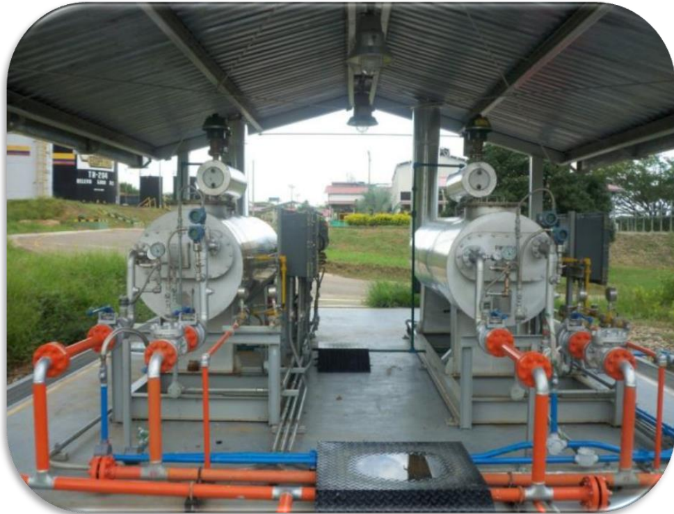
Figura 4. Foto de la estación de Calentadores
