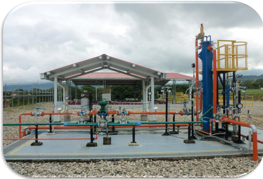
Figura 5. Fotografía de Estación de Regulación
