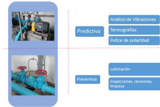
Figura 38: Sistema de bombeo
