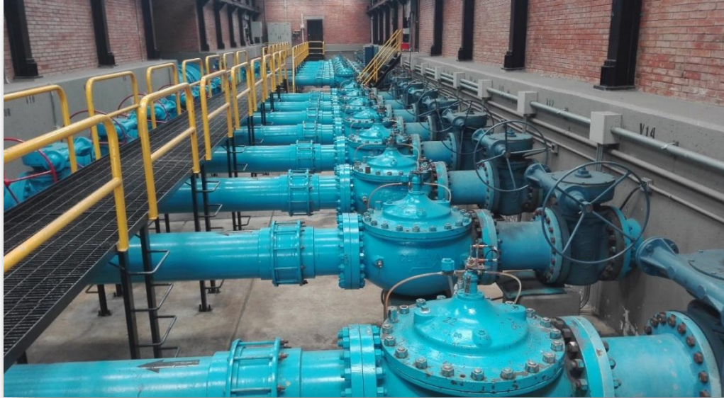
Figura 20. Reductoras de presión USAQUEN zona baja norte.
