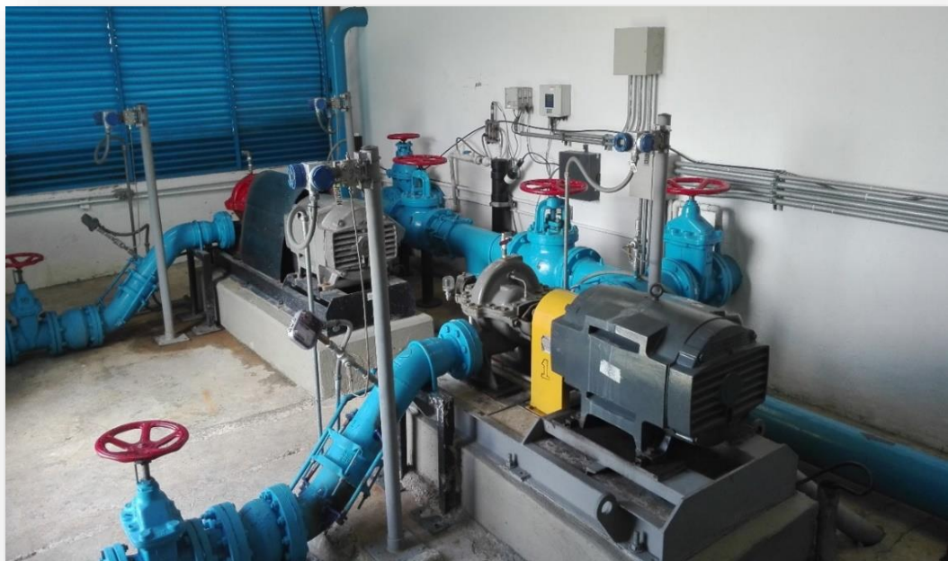
Figura 29. Unidades de bombeo Paraíso I
