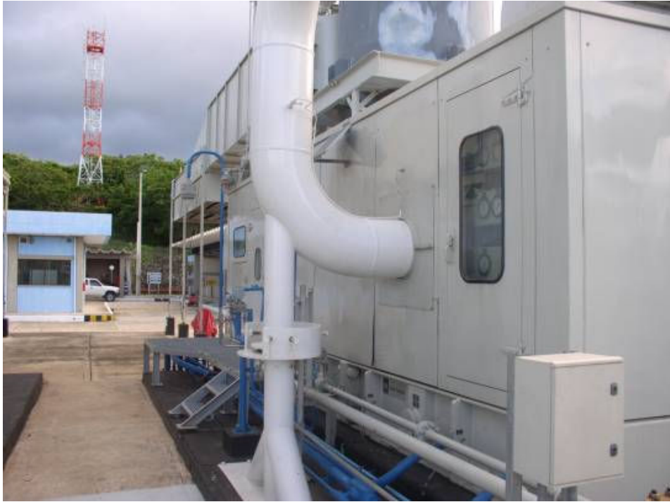
Figura 42. Cabina de la unidad turbocompresora
