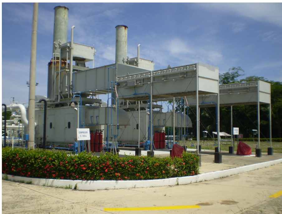
Figura 23. Turbocompresores estación compresoras Palomino
