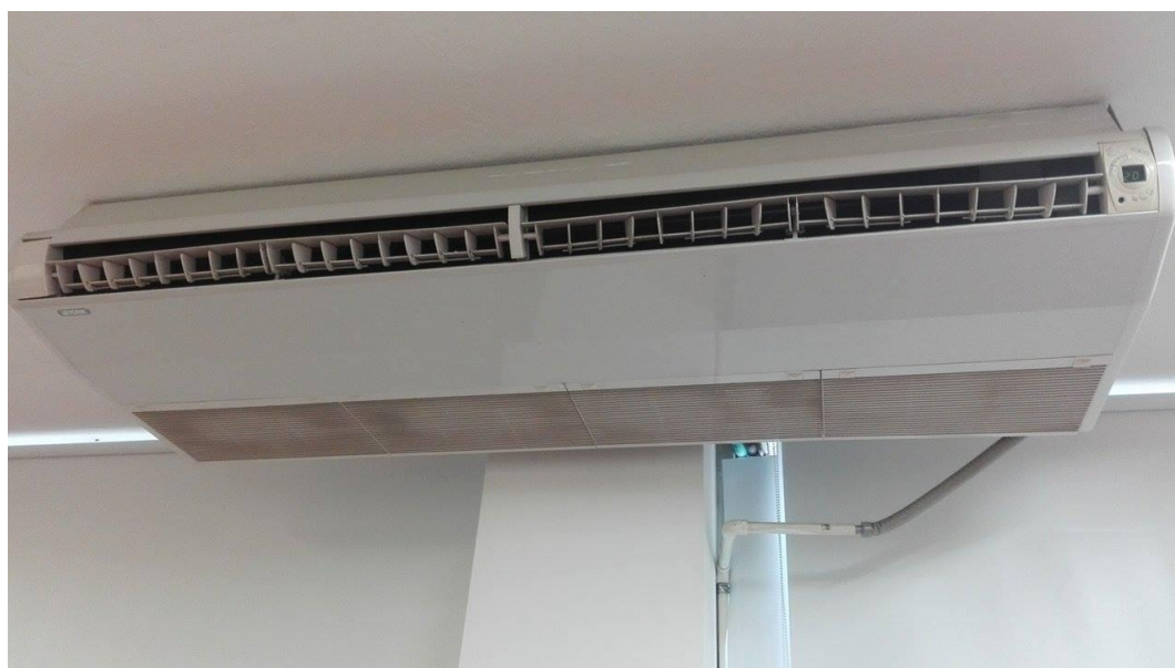
Ilustración 23. Aire acondicionado del laboratorio
