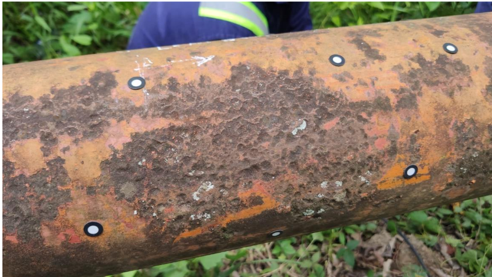
Figura 1. Tubería con corrosión
