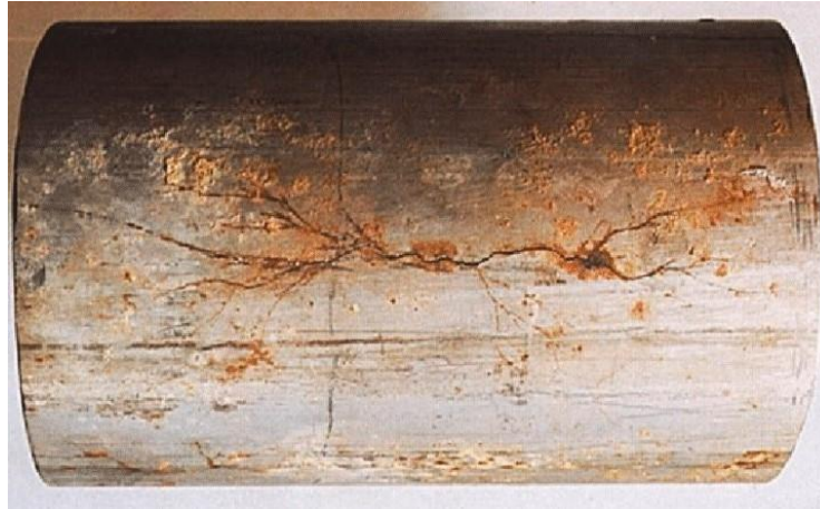
Figura 4. Grieta producida por corrosión.
