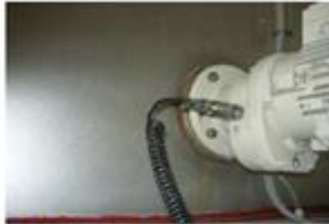
Figura 37. Medición de vibración en la bomba.
