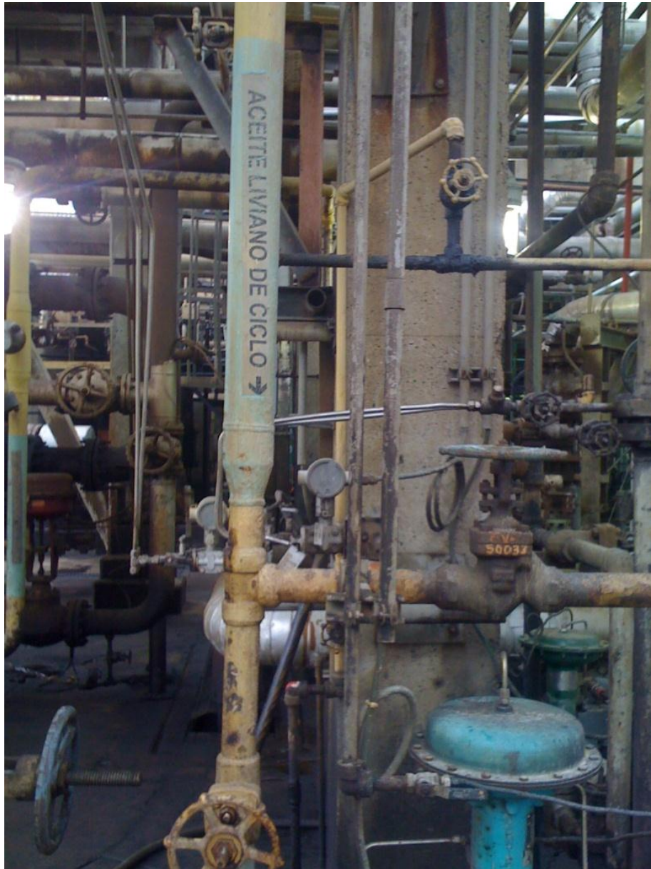
Foto 3. Válvula de salida de Aceite Liviano de Ciclo U-Cracking Orthoflow GRB.
