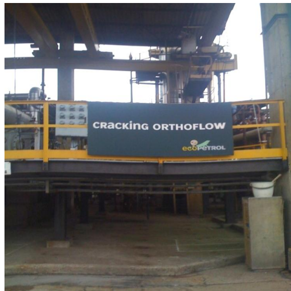
Foto 1. Interior de la Unidad Cracking Orthoflow Ecopetrol.
