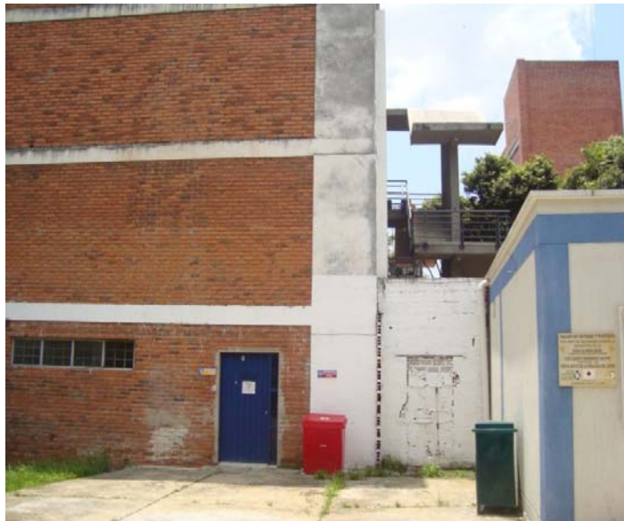
Figura 54. Incidencia estructural del costado Este de la edificación.
