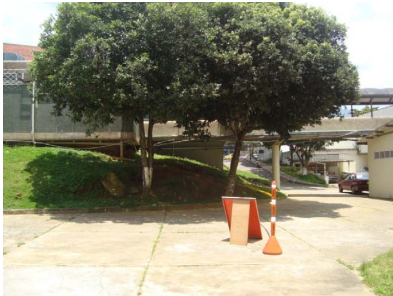
Figura 55. Incidencia estructural, frente del costado Este de la edificación.
