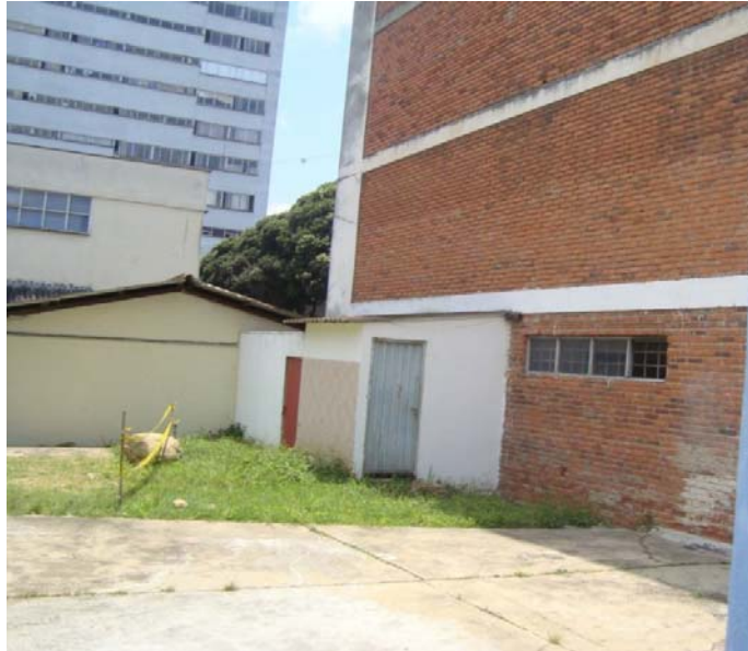
Figura 53. Incidencia estructural, frente del costado Este de la edificación.
