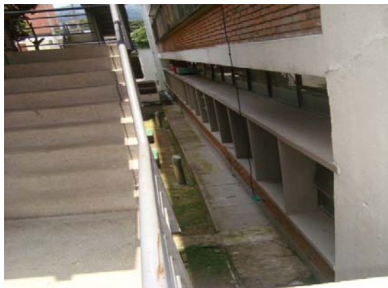
Figura 50. Incidencia estructural costado norte de la edificación.
