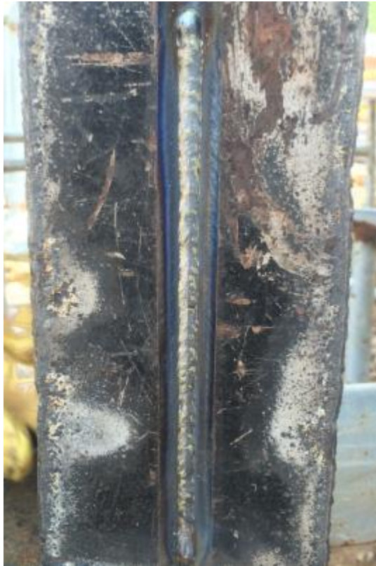
Imagen 1. Unión Soldada de Acero al Carbón.
