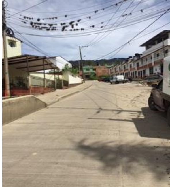
Figura 6. Obra después de la ejecución. Tomado de: Información de la oficina de la Secretaria de Infraestructura de la Gobernación de Santander.
