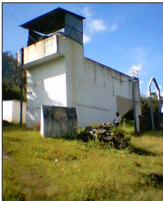
Ilustración N° 37. Planta de Tratamiento de Agua Potable.
