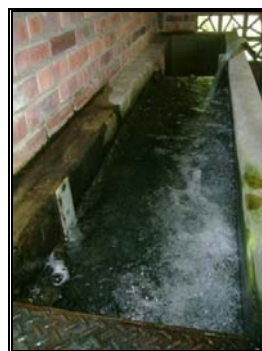
Ilustración N° 6. Cloración y Medición de caudal.
