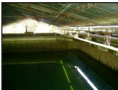
Ilustración N° 8. Tanques de Almacenamiento.
