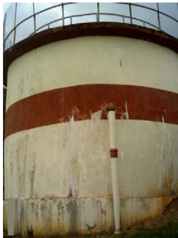
Ilustración N° 51. Tanque de floculación de P.T.A.P.
