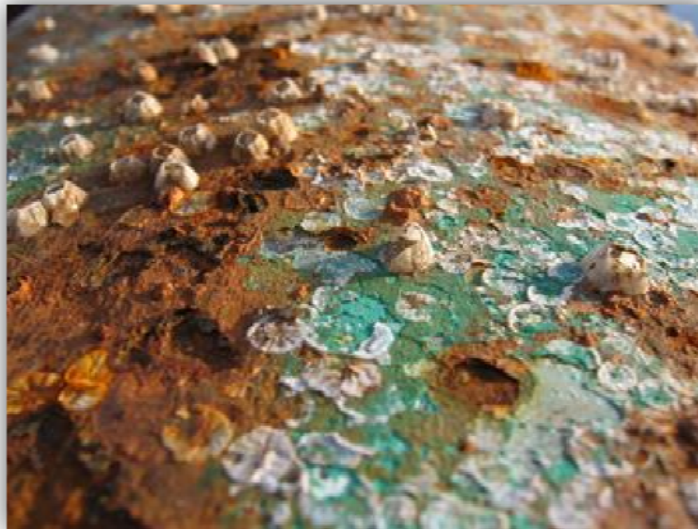
Figura 10. Ejemplo de corrosión en un metal bajo condiciones ambientales.
