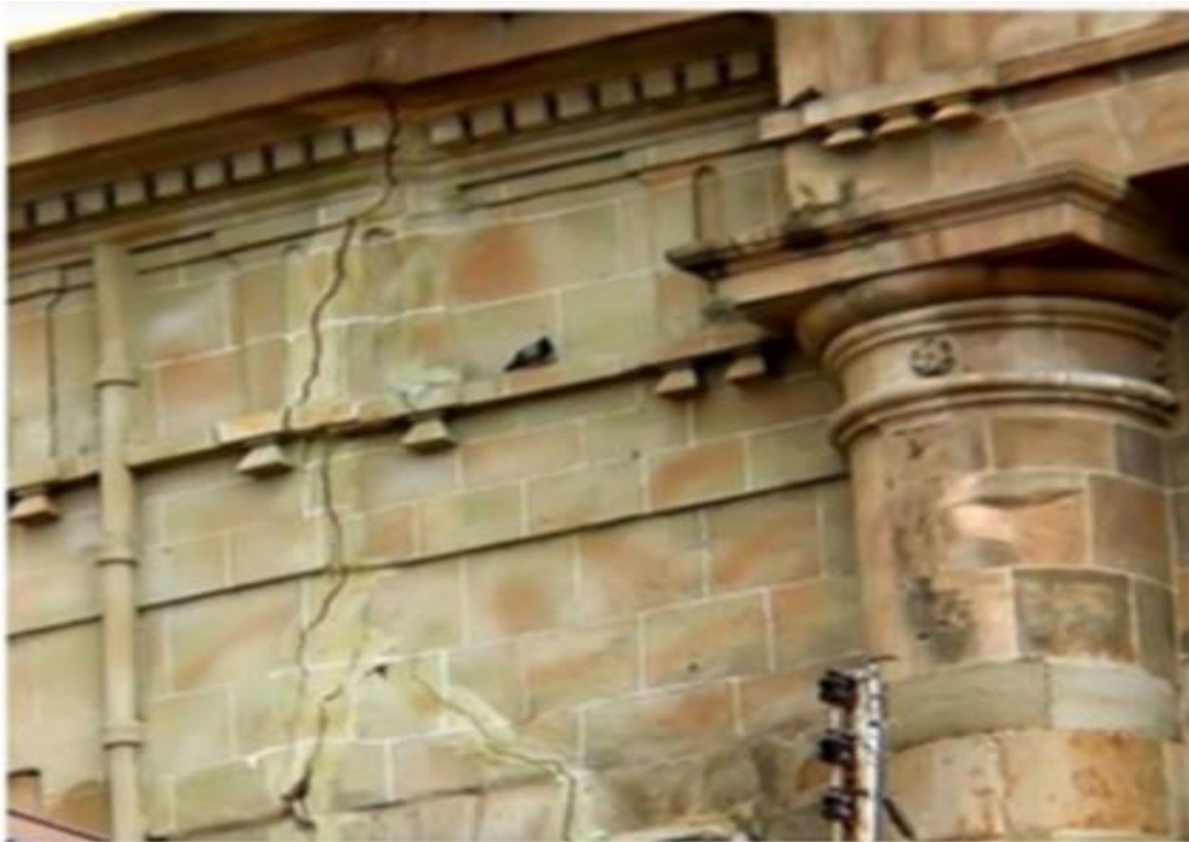
Fisura lateral de la catedral del Socorro
