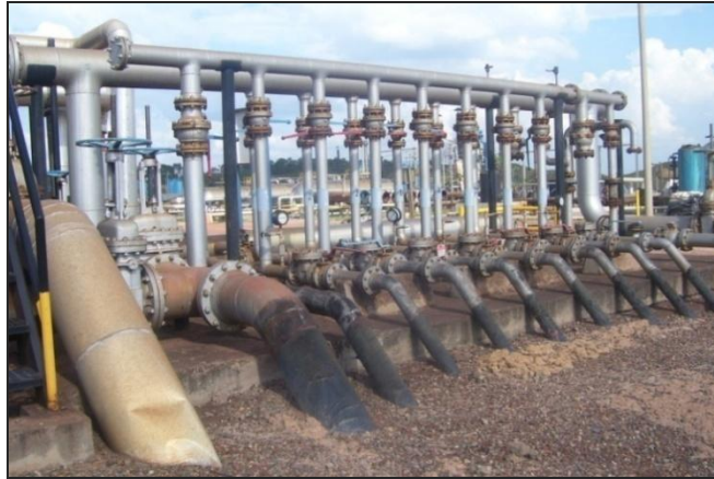
Figura 5. Múltiple o manifold y colectores.
