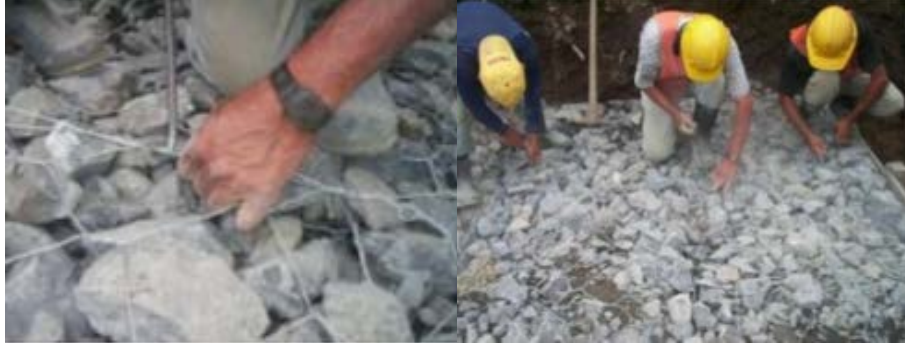
Figura 24. Sellado de la malla del gavión después del llenado de la caja.
