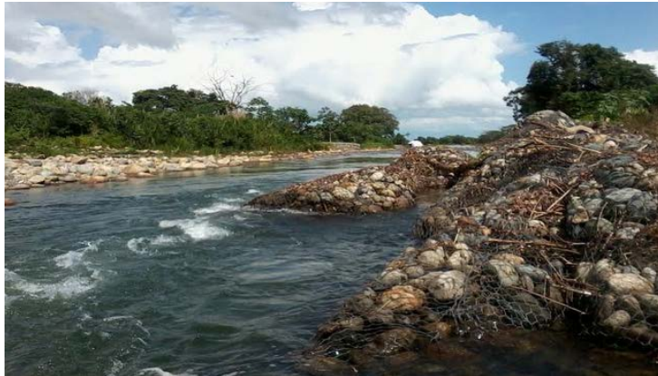
Figura 20. Colapso de puente construido con estribos de gravedad de gaviones producto de la socavación.
