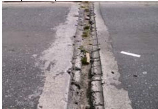
Figura 1. Deterioro de juntas en puentes construidos con estribos tradicionales.
