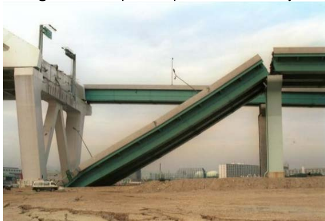
Figura 2. Colapso del puente Nishihomiya.
