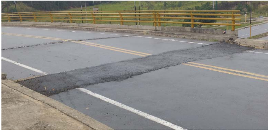
Figura 4. Desnivel entre el acceso y el tablero del puente producto del asentamiento del terreno.
