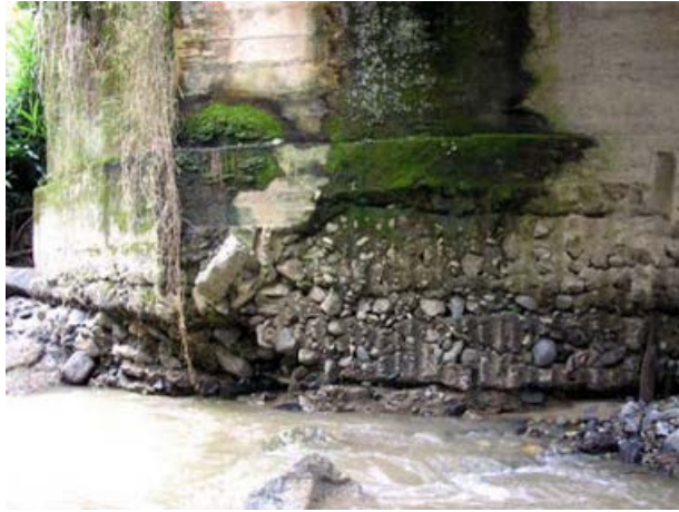
Figura 19. Ejemplo de socavación en estribo de puente.
