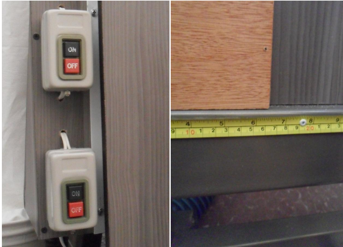
Figura 77. Interruptores de encendido y cintas métricas.
