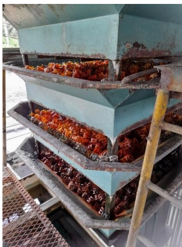
Figura 1. Fotografía torre de aireación
