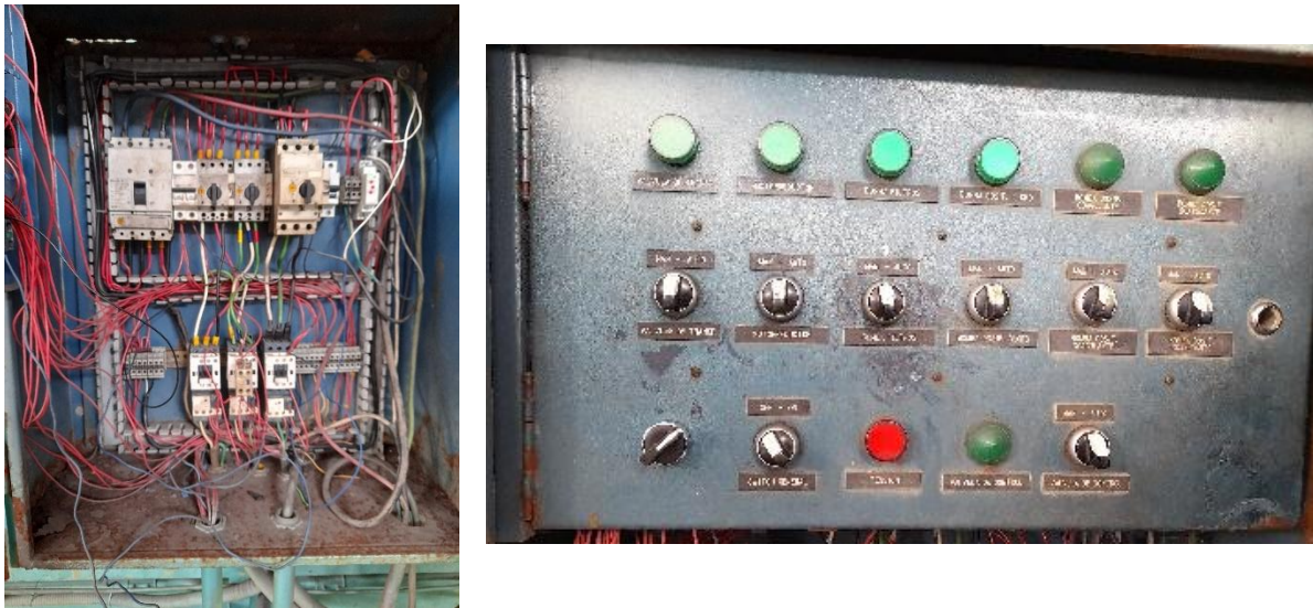
Figura 10. Fotografía del tablero de suministro eléctrico
