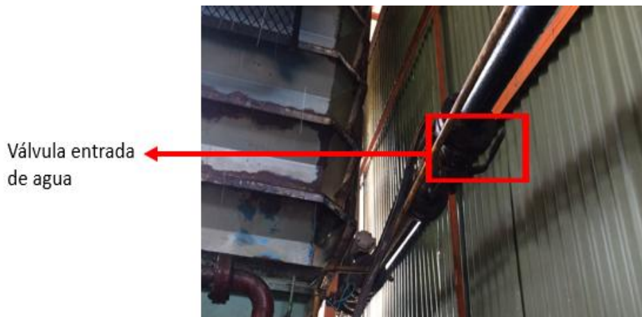
Figura 8. Fotografía apertura de la válvula de entrada de agua
