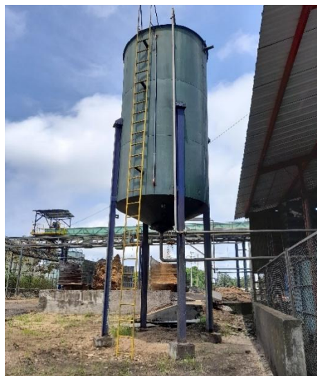
Figura 7. Fotografía de tanque de agua de emergencia
