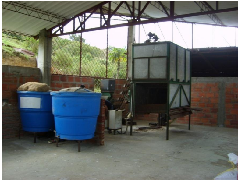
Foto 9. Aspecto general de algunos equipos ubicados en la planta de tratamiento de residuos sólidos orgánicos. Fuente: el Autor
