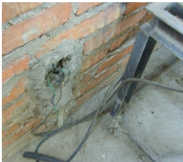
Foto 15. Conexiones eléctricas. Fuente: el Autor.
