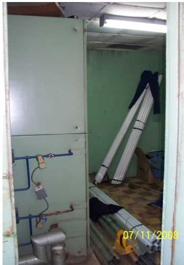
Figura 32. Cuarto de recirculación del aire del Split 30 TR.
