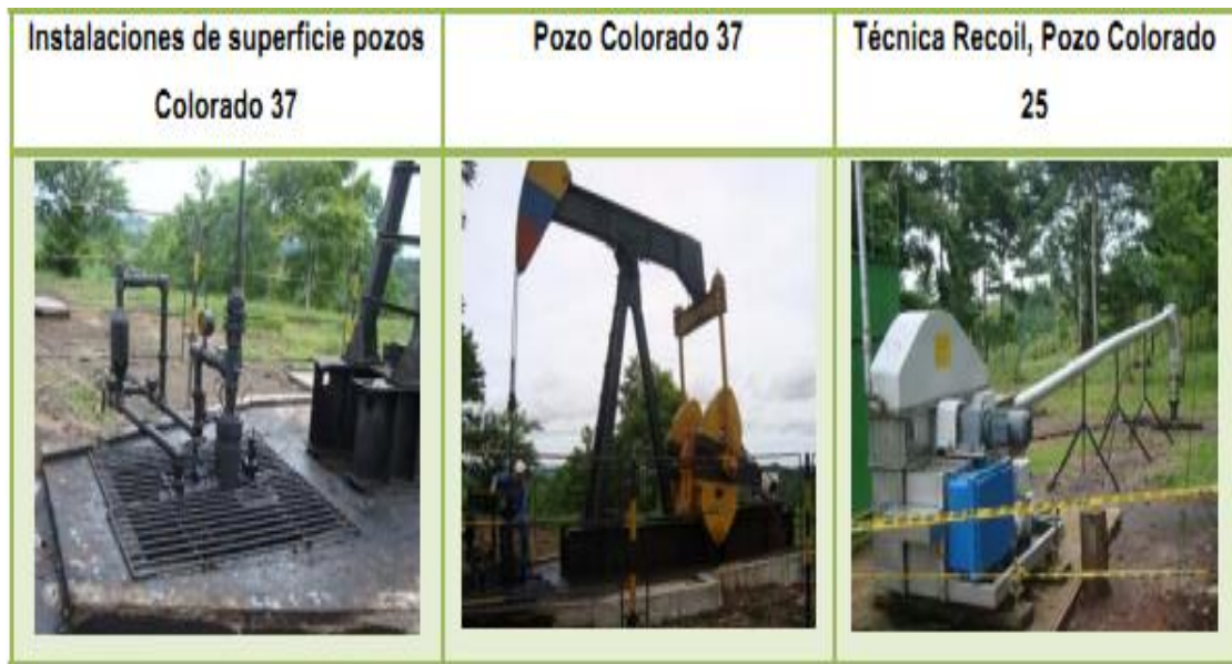
Figura 34. Instalaciones Pozos Colorado.
