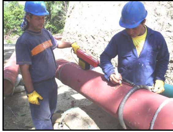
Foto 1.13. Inspección de revestimiento de la tubería, detección de puntos de falla.
