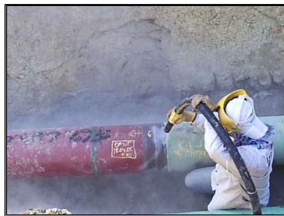
Foto 1.11. Limpieza de juntas con chorro de arena a presión o “sand blasting”.
