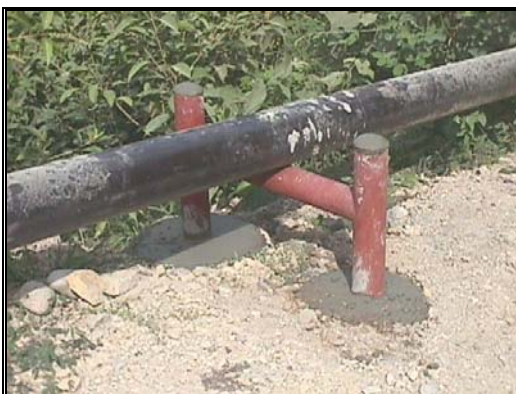
Foto 1.16. Equipo para sostener la línea de flujo.
