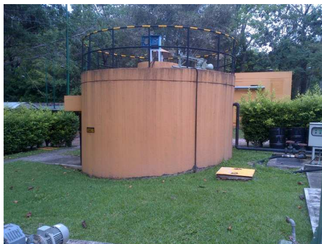
Figura 10 Biodigestor de Lodos
