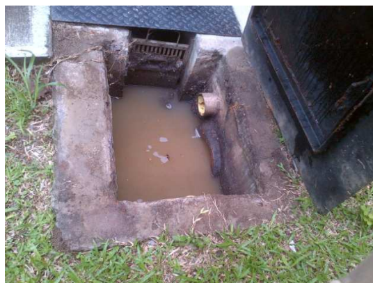
Figura 4 Cámara de Cribado
