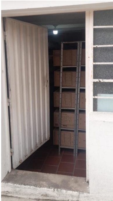
Entrada al Archivo histórico, por debajo del nivel del suelo. Se aprecia además iluminación deficiente
