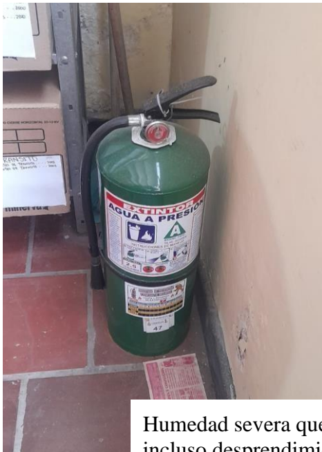
Se denota extintor base agua, que no cumple con el acuerdo 049 del 2000 (está contraindicado).
