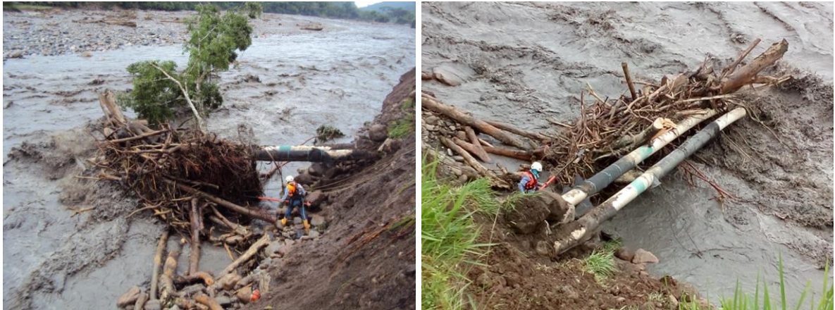
Figura 30. Exposición de tuberías por deslizamientos de terreno en cruces de río
