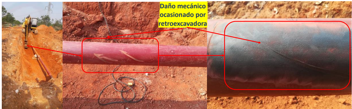
Figura 25. Daño mecánico con retroexcavadora
