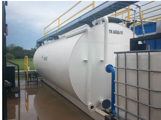
Figura 12. Tanque de almacenamiento de agua tratada
