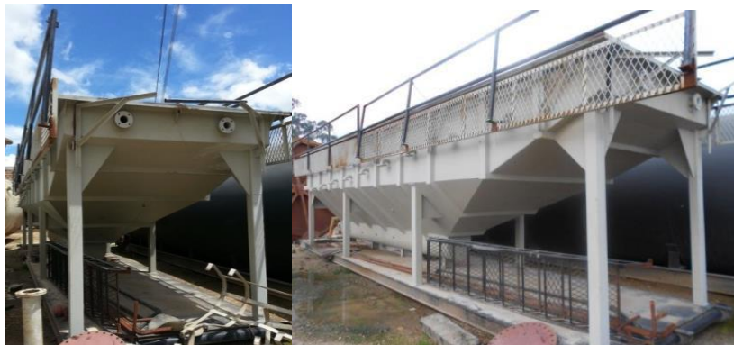
Figura 18. Tanque de lodos
