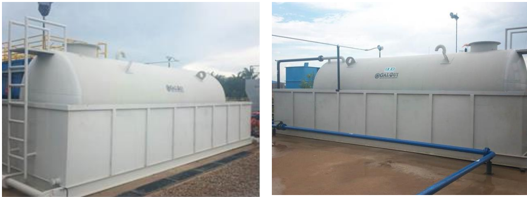
Figura 10. Tanque de recuperación de crudo
