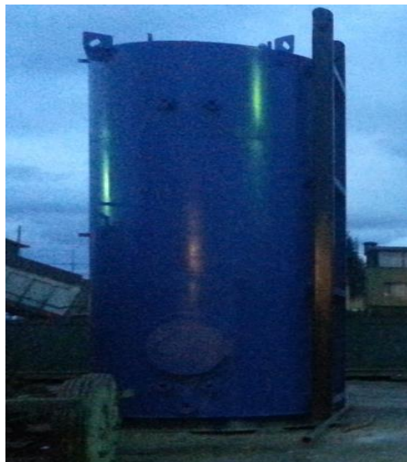
Figura 15. Tanque de aguas aceitosas
