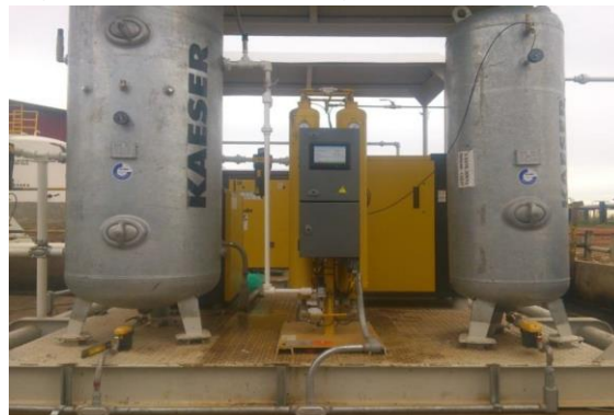
Figura 20. Tanque de generación de nitrógeno
