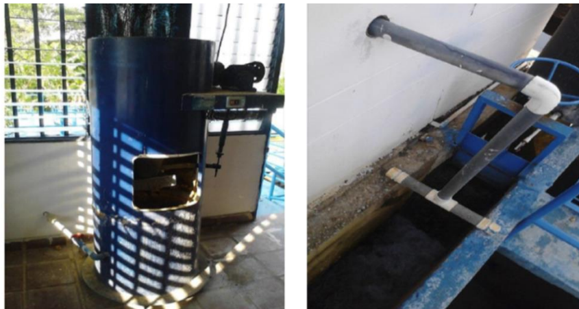
Figura 9. Dosificador de sulfato de aluminio (APCES E.P.S)
