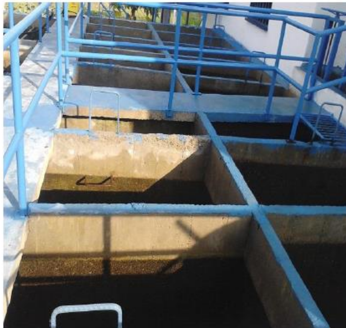
Figura 11. Floculadores (APCES E.P.S).
