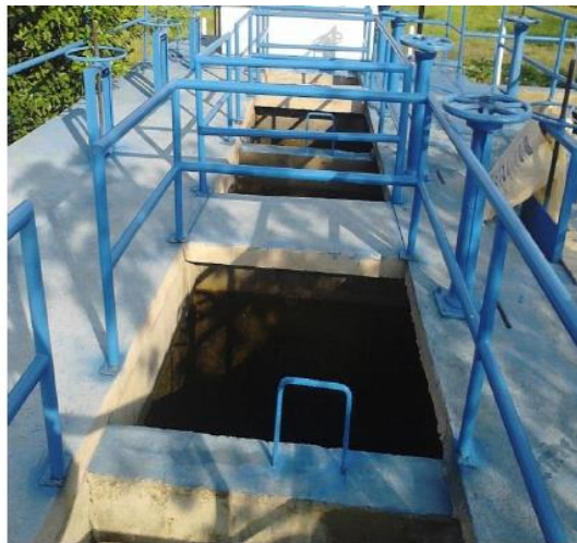
Figura 13. Filtros (APCES E.P.S)
