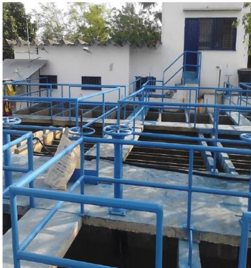
Figura 1. Planta de tratamiento de agua cruda de APCES E.S.P.
