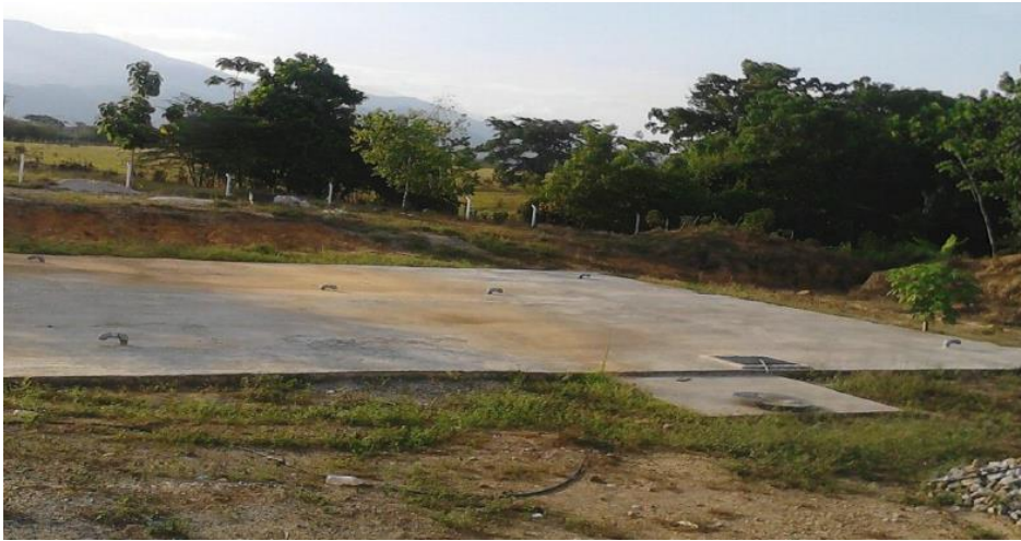
Figura 15. Vista superior del tanque subterráneo para almacenamiento (APCES E.P.S).
