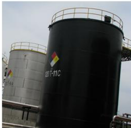
Imagen 2. Tanques de almacenamiento de CPO, metanol, metilato, ácido sulfúrico y ácido clorhídrico
