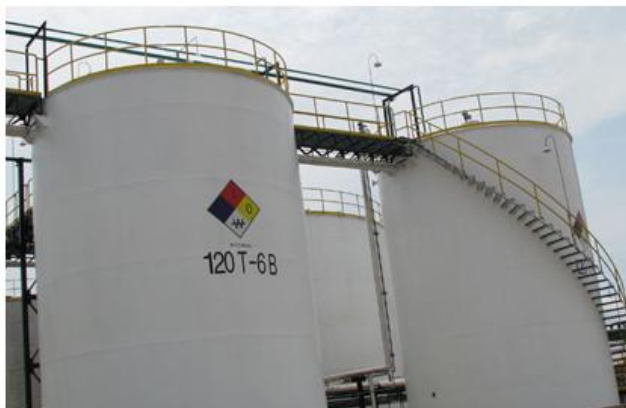
Imagen 6. Tanques de almacenamiento de Biodiesel y subproductos
