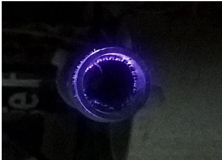
Figura 18. Efecto corona en la celda. Vista Frontal.
