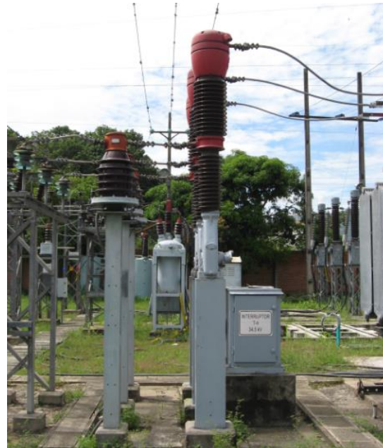
Equipos de la Bahía de transformación asociada al lado de baja del Transformador T-4
