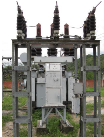
Equipos de la Bahía de transformación asociada al lado de alta del Transformador T-7
