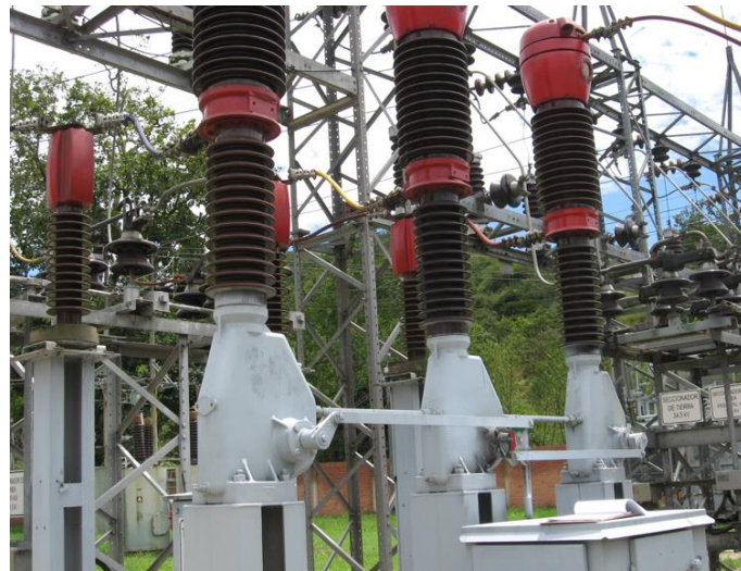
Equipos de la Bahía de la Línea 406 Sur-Palenque
