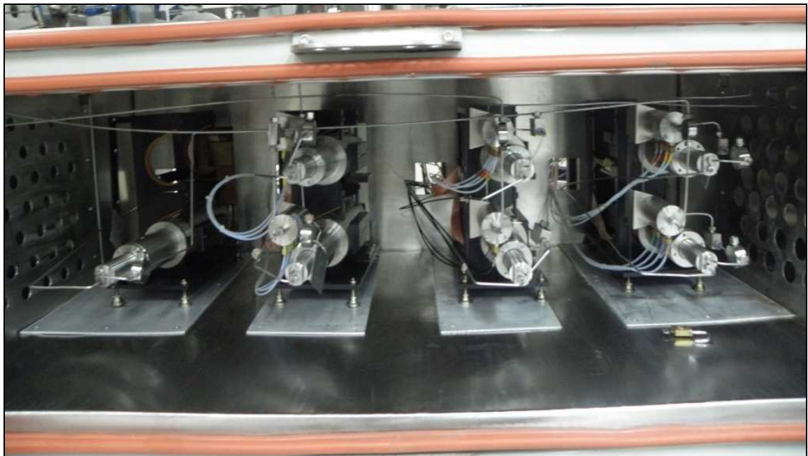
Fotografía 4. Sistema (7) Bombas de desplazamiento.
