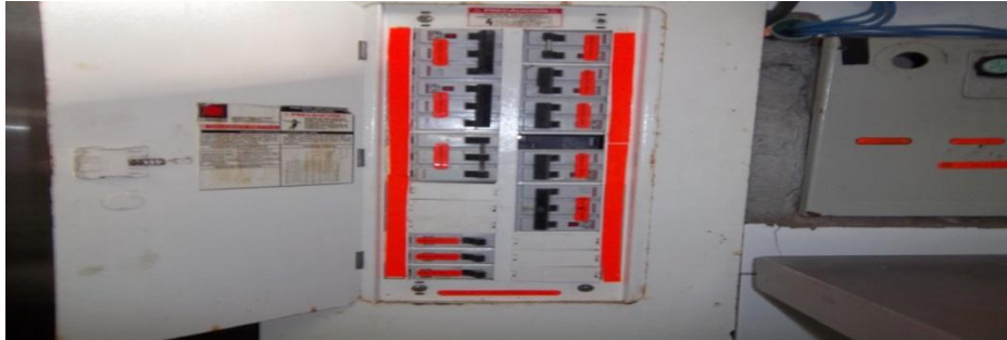
Ilustración 8. Fotos de algunos tableros, tomas y luces presentes en el edificio
