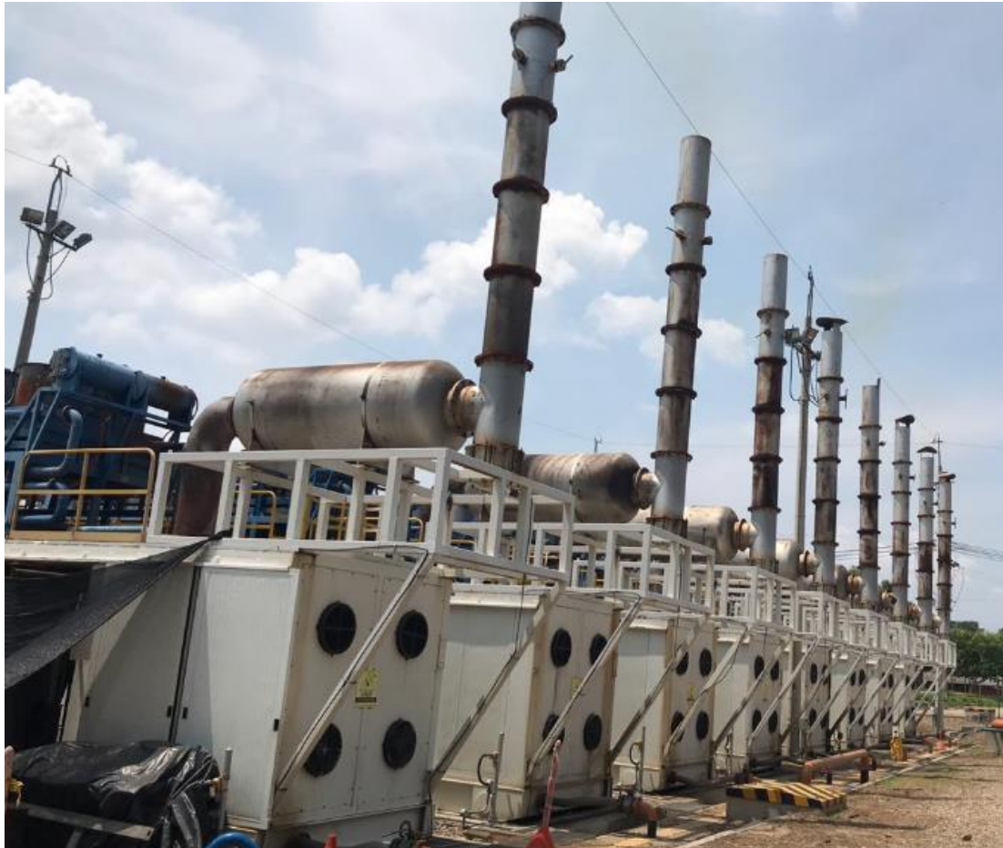
Figura 24: Unidades de generación a gas
