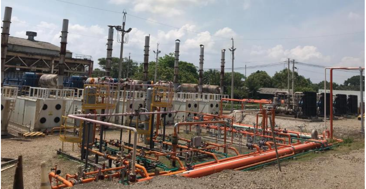
Figura 10: Planta de autogeneración el Centro
