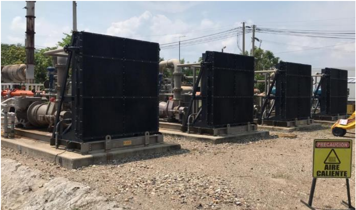
Figura 16: Skid's de compresión
