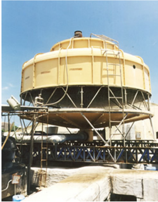
Figura 1. Torre de enfriamiento SAO (Santa Marta)
