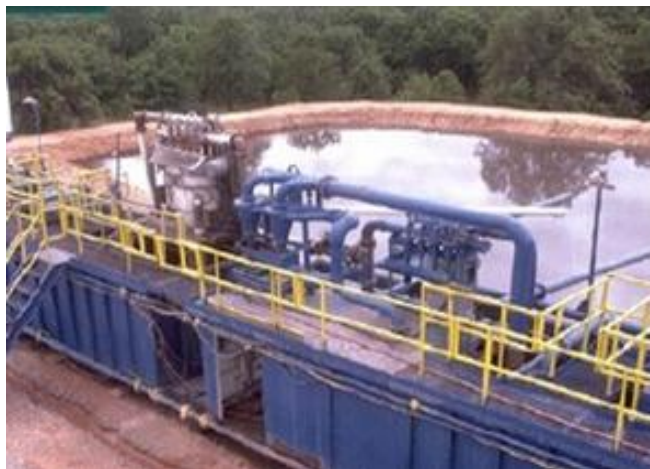
Figura 22. Tanques de almacenamiento de lodo
