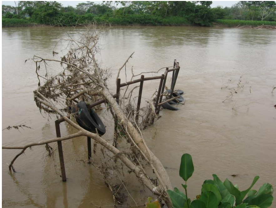
Figura 33. Socavación en la orilla de un espigón de llantas y tubería
