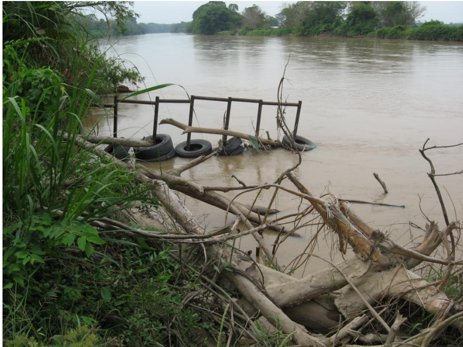
Figura 34. Socavación en el lecho del río en un espigón de llantas y tubería
