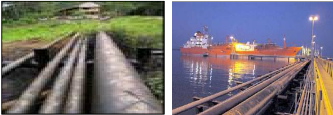
Figura 2. Tuberías de Transporte de Crudo y Derivados.
