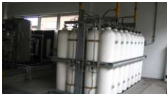
Figura 9. Unidad de almacenamiento.
