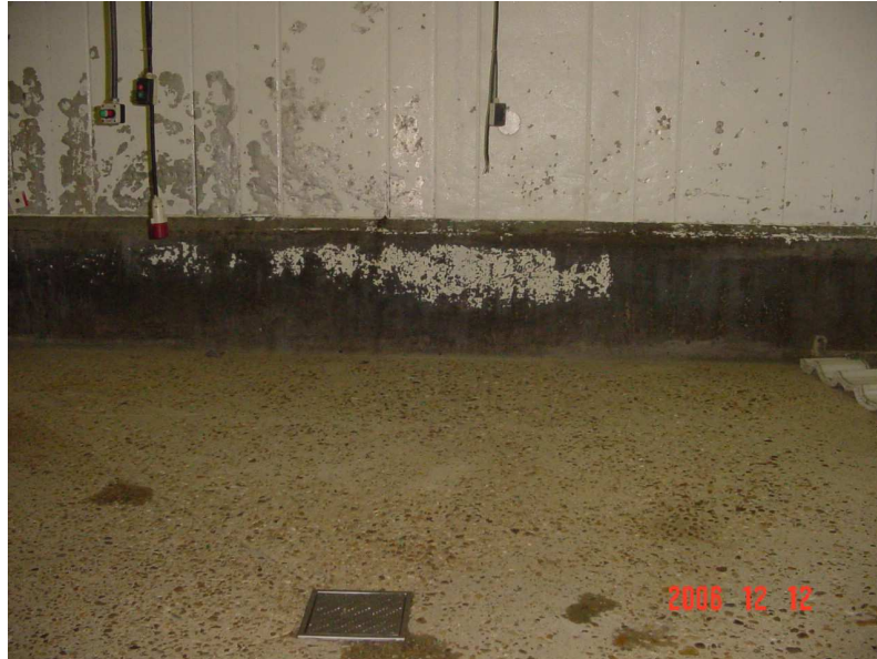
Figura 5. Estado del piso del salón.
