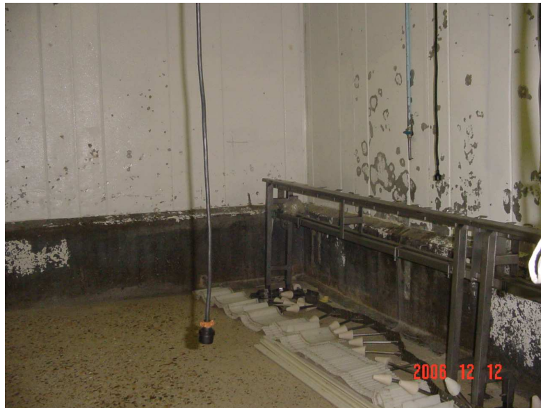
Figura 4. Estado de algunas de las paredes del salón.
