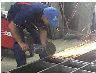
Figura 25. Personal sin elementos de protección.
