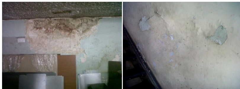
Figura 44. Paredes en mal estado
