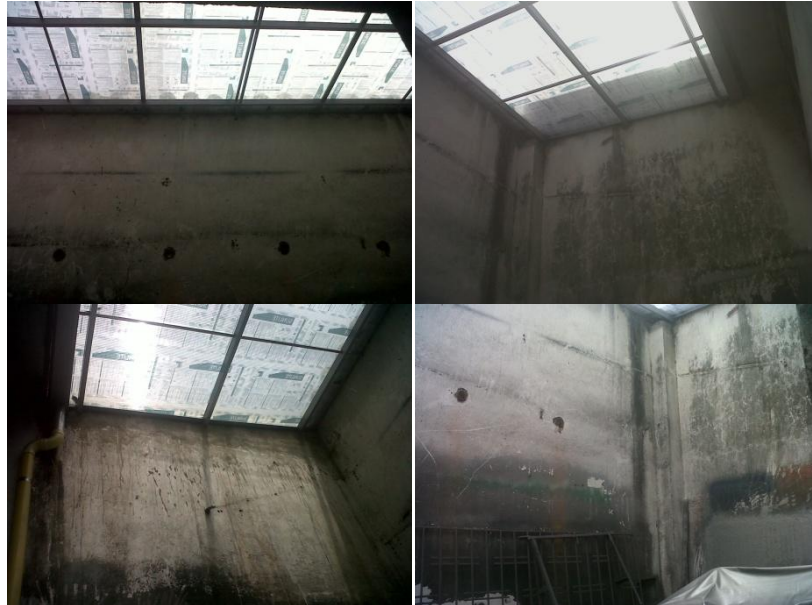
Figura 24. Área de pintura sin ventilación.
