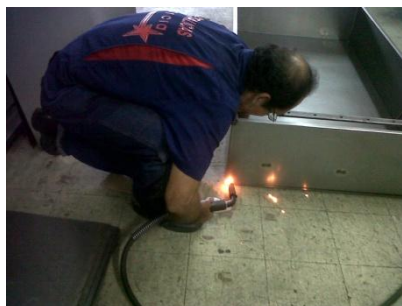
Figura 23. Personal sin utilizar elementos de seguridad personal.
