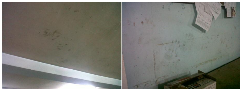
Figura 43. Techo y paredes sucios
