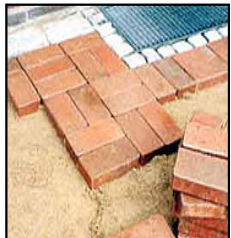
Figura 2. Detalle de instalación.
