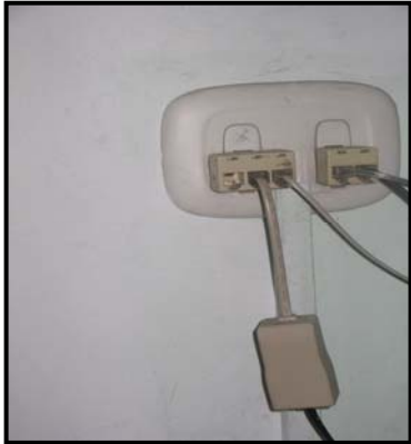
Canalización de cables y multitomas
