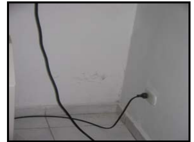
Humedad en el consultorio
