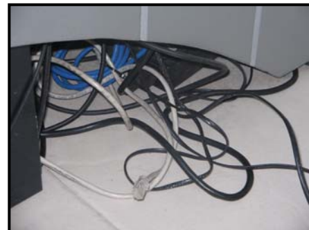
Cables a la vista zona comercial
