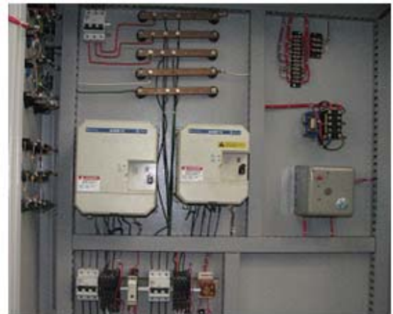
b) Variadores de velocidad
