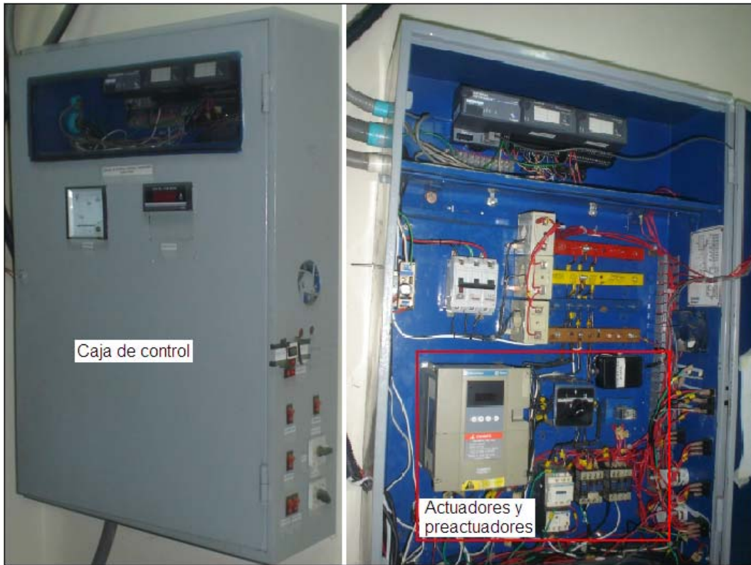
Figura 75. Caja de Control - Cuarto Frío
