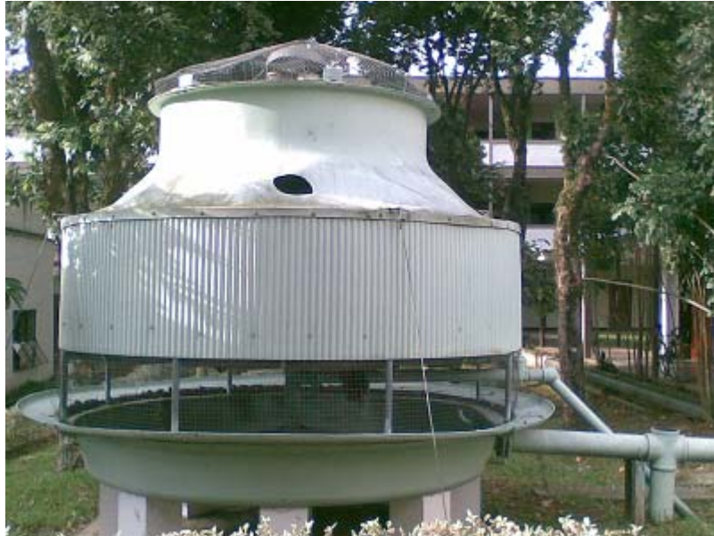
Figura 58. Torre de Enfriamiento
