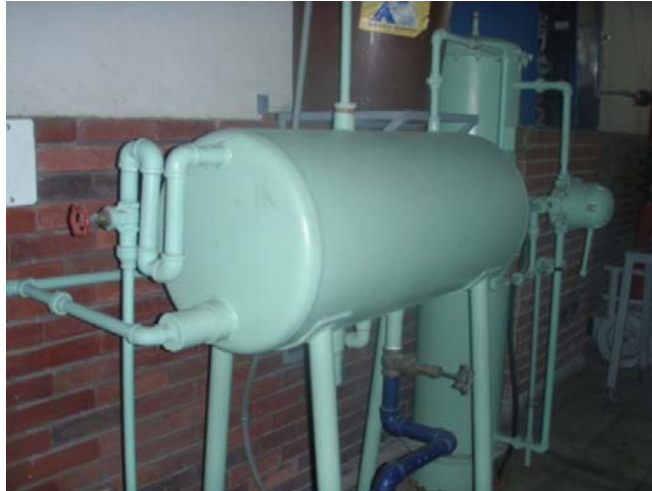
Figura 7. Tanque de condensado
