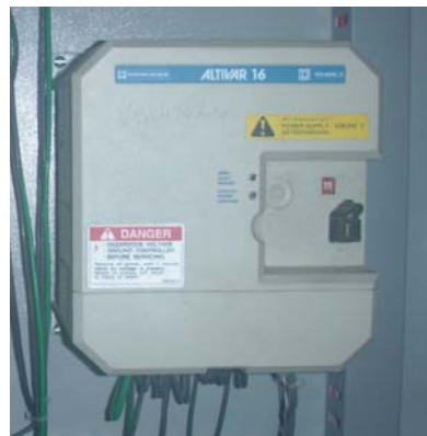
Figura 28. Variador de velocidad del motor ventilador.
