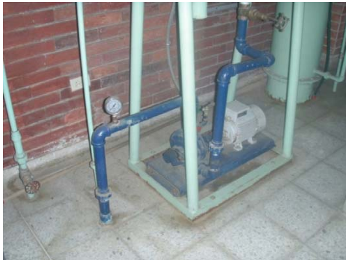
Figura 6. Bomba de alimentación de agua
