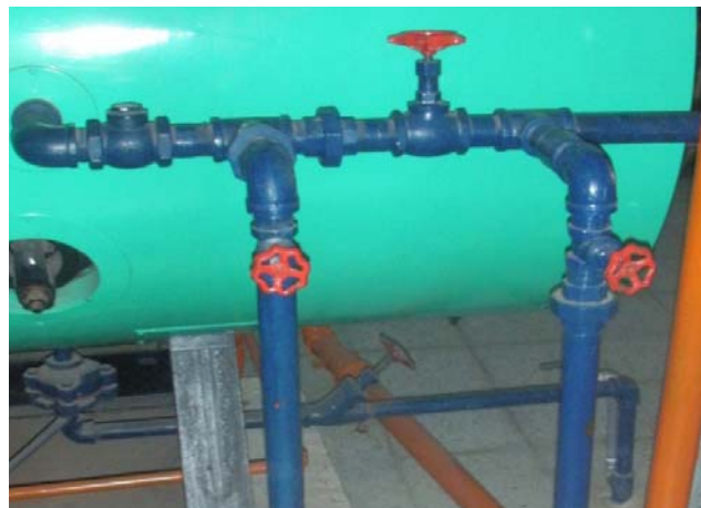
Figura 9. Conjunto de válvulas del sistema de alimentación de agua
