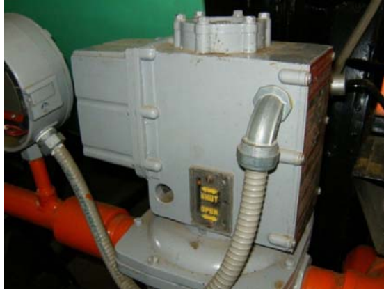
Figura 18. Válvula principal de combustible
