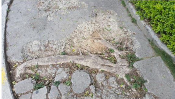
Fig. 1 Fotografía de andén partido por la fuerza de la raíz de un árbol en Bucaramanga
