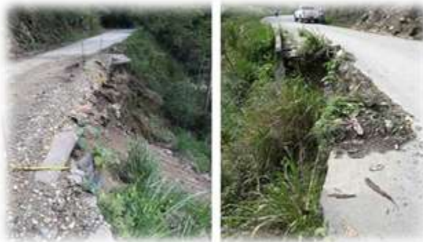
Figura 6. Erosión de banca de la vía
