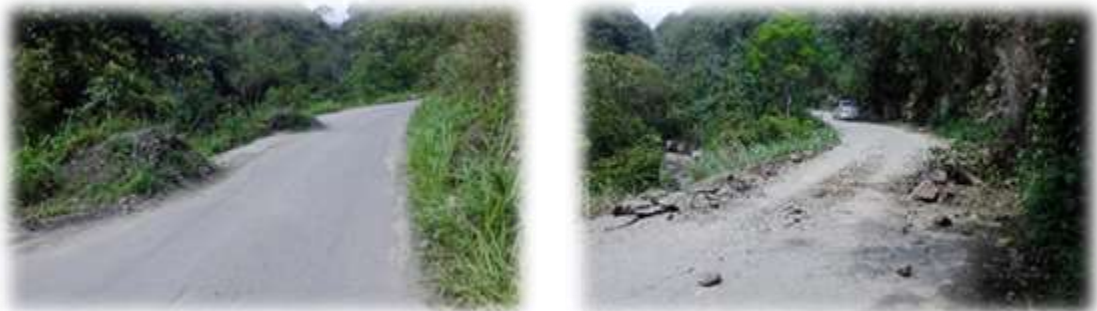
Figura 5. Presencia de escombros y derrumbes en la vía
